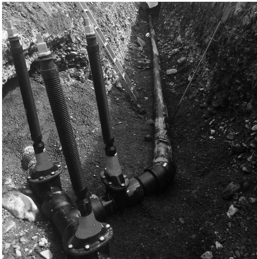
Der Bau von Trinkwasserleitungen ist mit der Übernahme der Firma SLH in Untervaz ein weiteres Standbein der Albert Casutt Gebäudetechnik AG.
