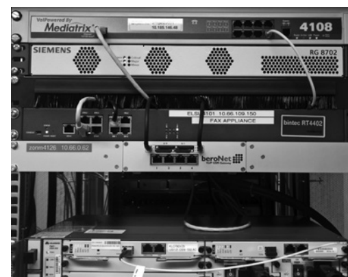
Unser Bild zeigt das Herz der Anlage für das digitale Kommunikationssystem, wie es von Rafael Emmenegger am Flughafen Zürich und an der Werdstrasse installiert wurde.
