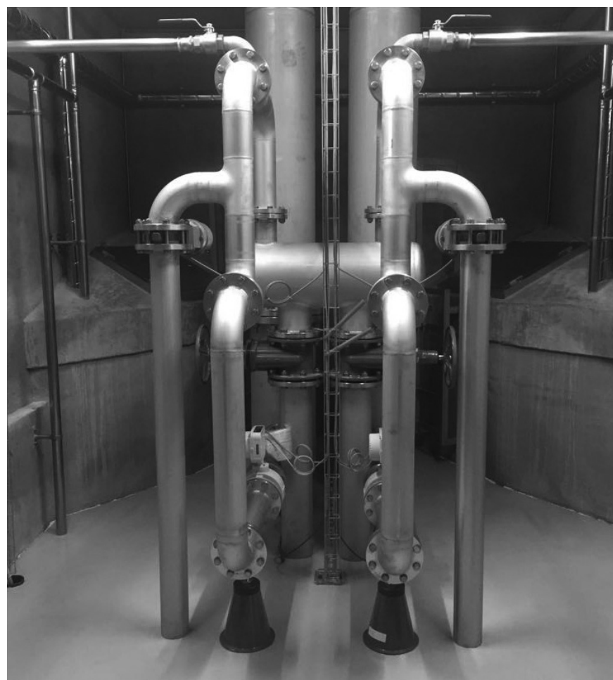
Heizungen und Warmwasseraufbereitung sowie Entkalkungsanlage das sind Gebiete, welche die Firma in hoher Qualität installiert und unterhält.
