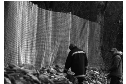
Ein Maschendrahtzaun, der bis jetzt nur in Teilen noch vorhanden war, soll die kulturhistorisch wertvolle Mauer schützen.
